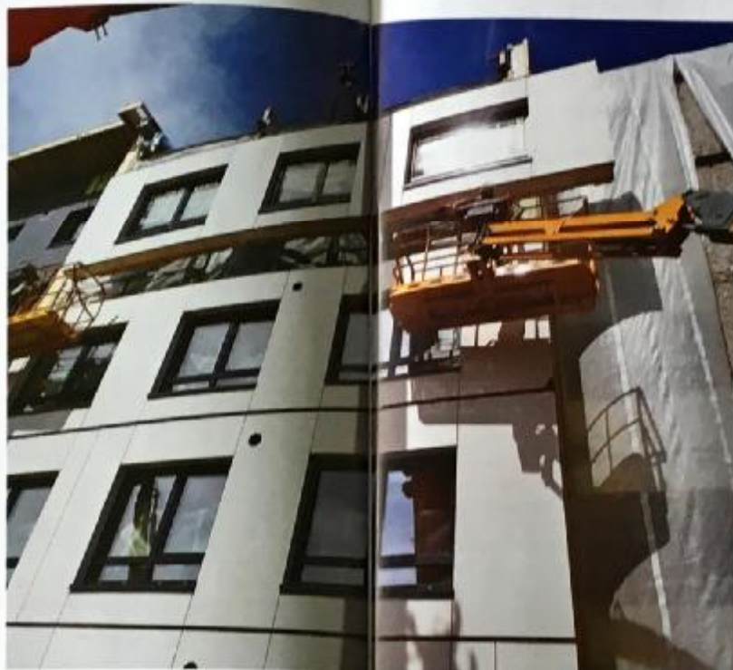
Liginullenergiahooneks ümber ehitatud TTÜ pereühisuse büroo jaoks valmistati tehases välisseinu ja katust katvad liis-soojustuselemendid, seinaelementidesse paigaldati ventilatsioonitorustikud.
